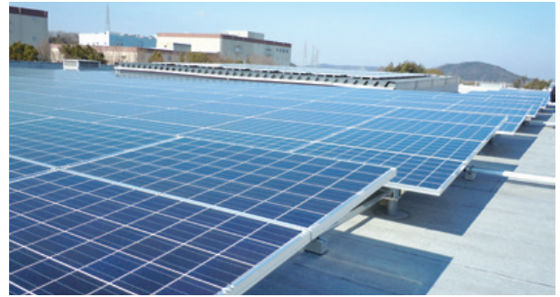
(株)ファンケル美健滋賀工場 太陽光発電システム
